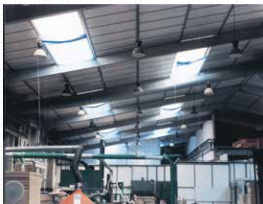
■ Ecrans sous toiture
