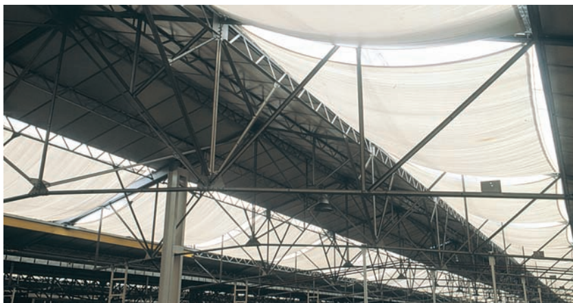
Ecrans sous toiture
