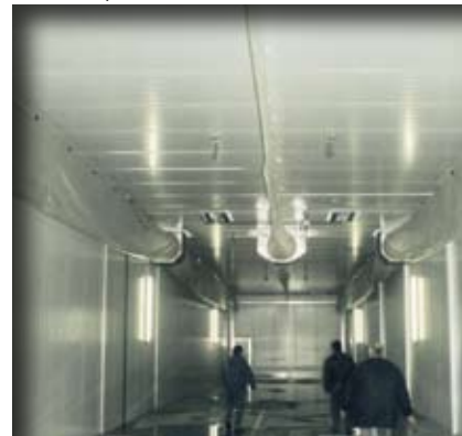
Gaines pour ventilation ou chauffage.
